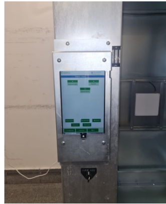
Sistema Touch sobre la Cabina para la ejecución de Operaciones.
